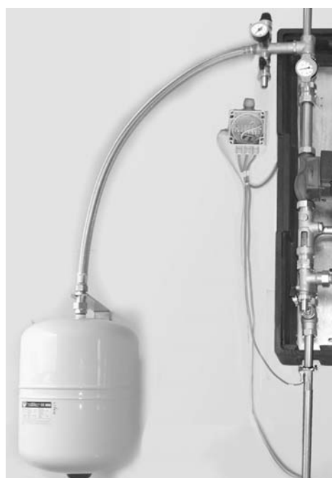
Vaso di espansione (qui: SOL-24) montato
