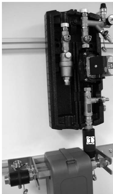
Unità circuito solare primario inserita
