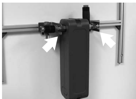
Scambiatore di calore a piastre installato
