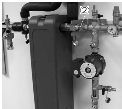
Tratto della pompa installato
