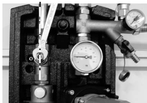
Valvola di arresto della mandata solare (AV) aperta
