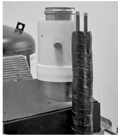
Raccordo di misurazione dei gas di scarico
