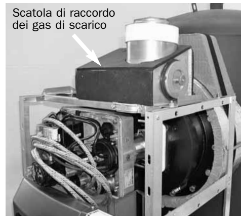
Mensola montata alla caldaia
