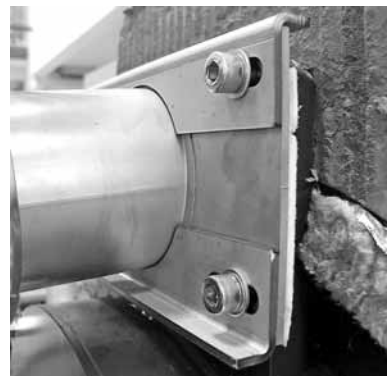
Flangia di raccordo dei gas di scarico con profili angolari
