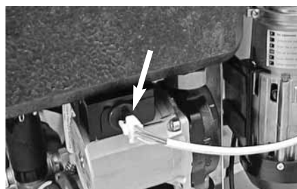
Pompa per acqua calda
