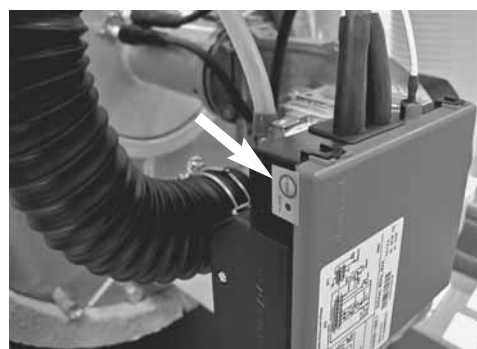
Pulsante Reset del dispositivo automatico di controllo
