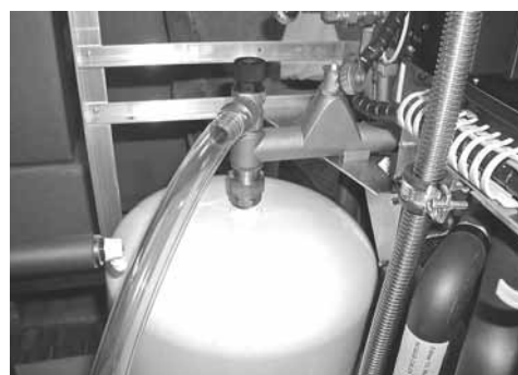
Vaso di espansione e tubo di scarico
