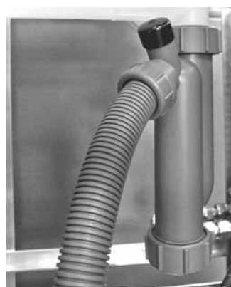
Sifone con tubo flessibile per la condensa
