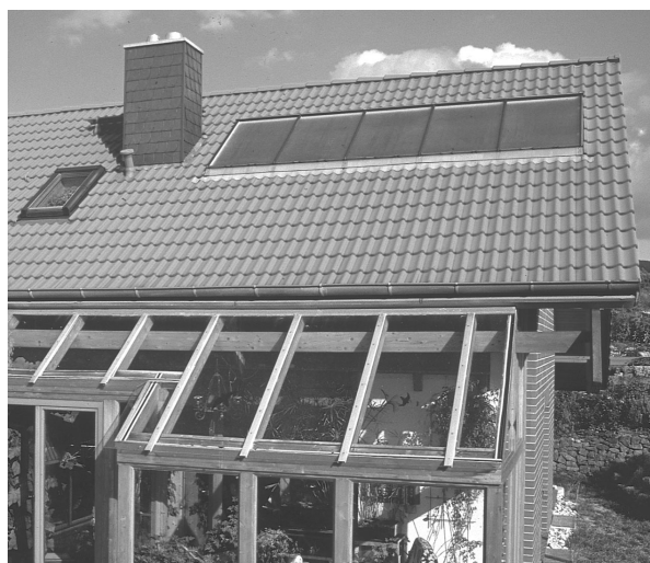
Fig. 5: Montaggio integrato nel tetto
