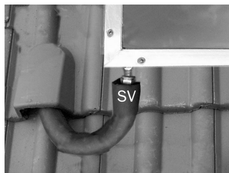
Fig. 54: Collegamento (conduttura solare di mandata) con isolamento
