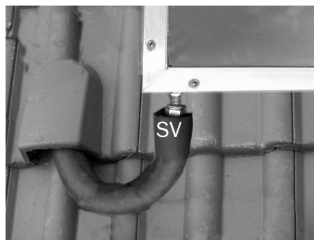
Fig. 64: Collegamento (conduttura solare di mandata) con isolamento
