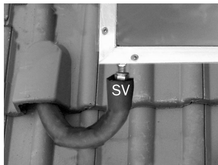
Fig. 68: Collegamento (conduttura solare di mandata) con isolamento
