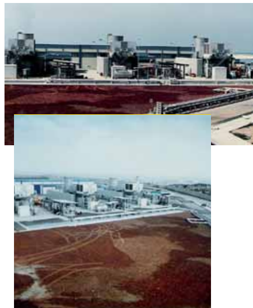
Vista panoramica di una centrale turbogas 3x30 MW
