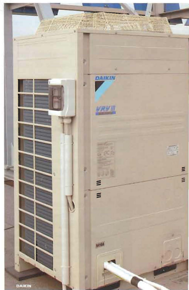
1 Esempio di unità motocondensante esterna VRV.
