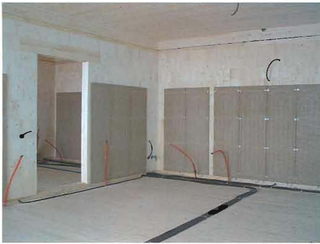
4 Il riscaldamento del centro di integrazione è posato prevalentemente a parete: l'elemento radiante è costituito da un pannello di argilla modulare con un circuito termico integrato.
